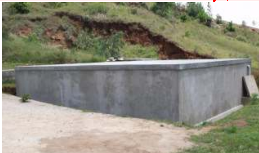
Réservoir de 50 m 3 - Source Naturelle d'Andasy – LOHALAMBO 1 200 mètres d'altitude. Financement : Ministère de l'Aménagement du Territoire et de la Décentralisation.
